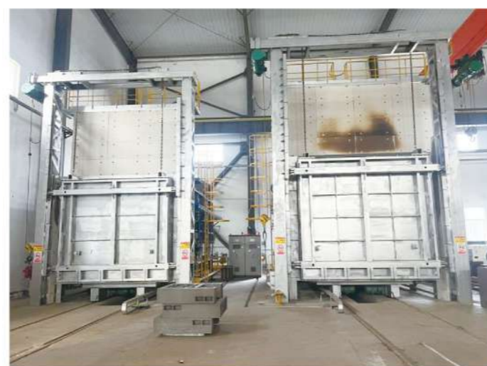
天然气热处理时效炉
